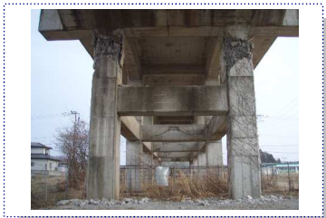
本震(3,11)による被害状況(2層の破損)
